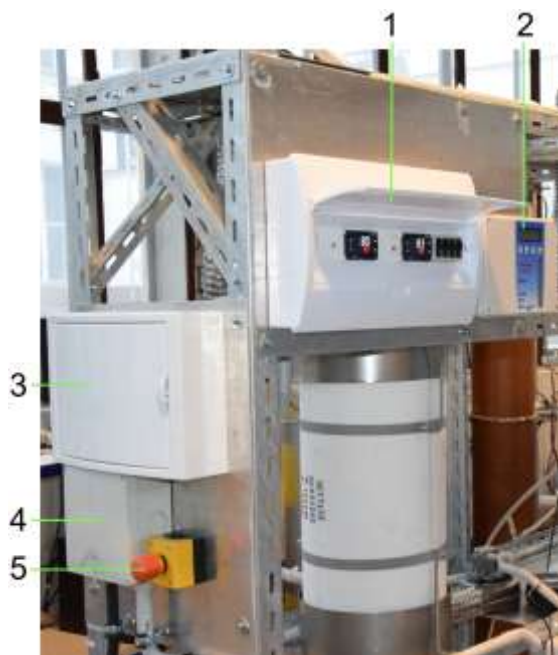
Obr. 7 Levý bok testovací jednotky: 1 – kontrolní panel teploty, 2 – měřicí ústředna (teplota, průtok plynu), 3 – skříňka jističů a proudových chráničů, 4 – hlavní elektrický rozvaděč, 5 – celkový nouzový vypínač
