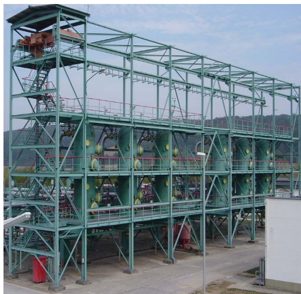
Obr. 2: Foto adsorpčního zařízení určeného k odsíření zemního plynu těženého z podzemního zásobníku Fig. 2: Photo of an adsorption plant designed for the desulfurization of natural gas extracted from an underground storage facility
