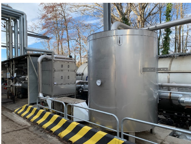
Obr. 6: Foto adsorbéru pro záchyt siřných látek z odpadních plynů vznikajících při modifikaci asfaltových směsí
