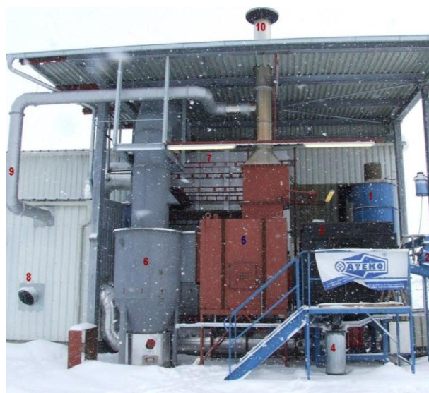
Obr. 7 IFGT zařízení v Lánech (prosinec 2010)
