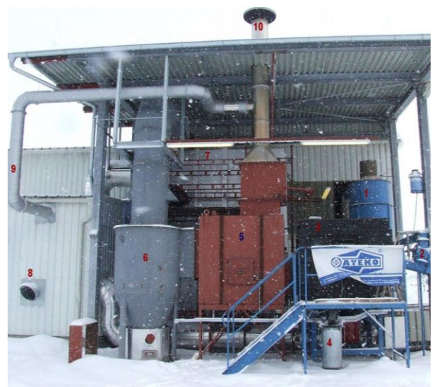
Obr. 7 IFGT zařízení v Lánech (prosinec 2010)
