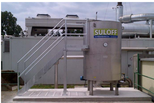
Obr.1: Foto adsorbéru určeného k odsíření bioplynu Fig. 1: Photo of adsorber designed for biogas desulfurization
