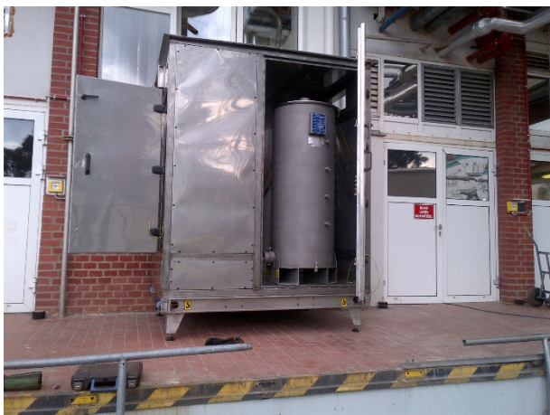
Obr. 5: Foto adsorpčního zařízení použitého k čištění odpadních plynů s vysokým obsahem siřných látek vznikajících při výrobě léčiv
