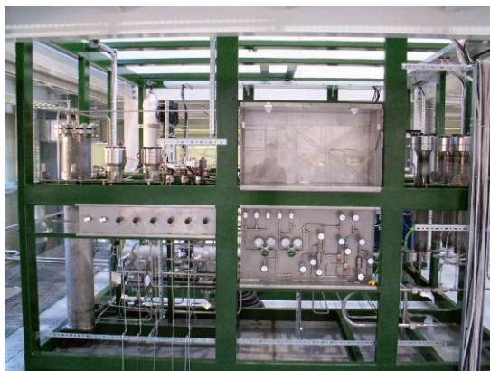
Obr. 4 Komponenty systému čištění a kontroly čistoty helia a dávkování nečistot umístěné v ocelovém rámu 3,5·3, 4·2,7 m
