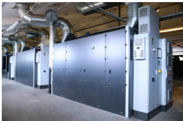
Obr. 4 Jednotka Holzenergie instalovaná v Lotyšsku Fig. 4 Holzenergie unit in Latvia
