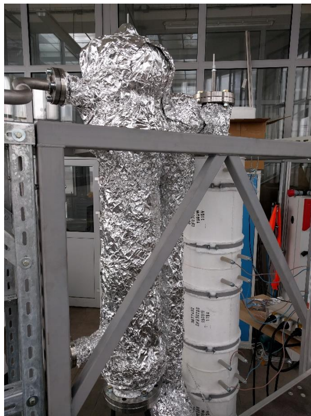
Obr. 3 Fotografie aparatury s fluidní vrstvou sorbentu
