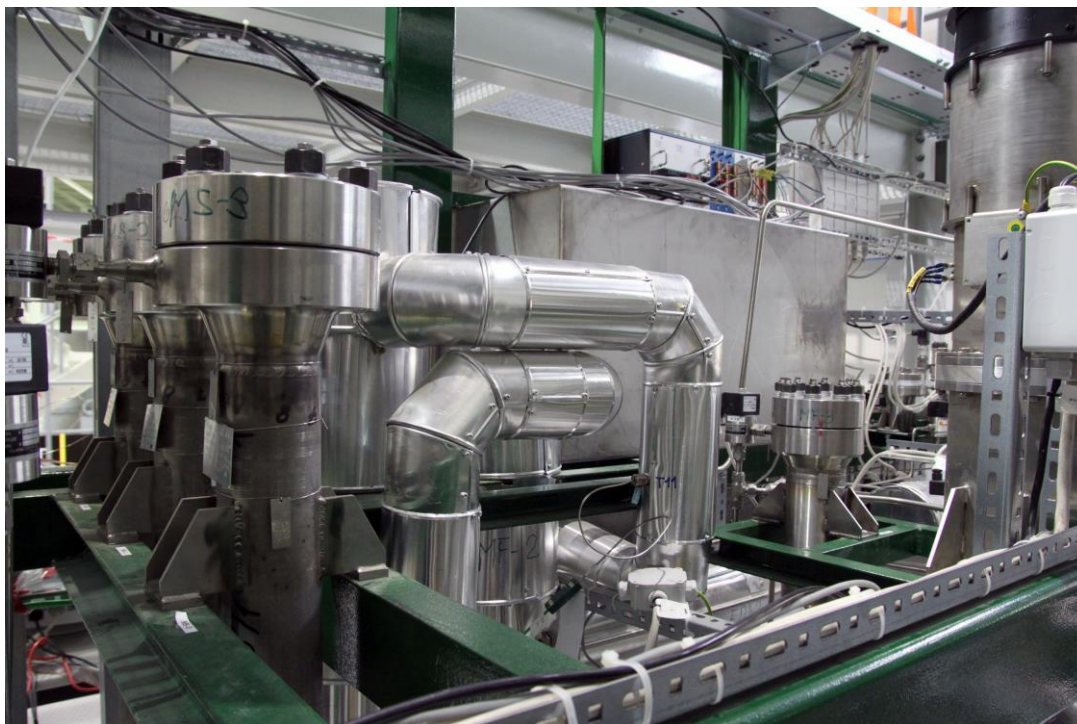
Obr. 6 Část systému čištění helia HTHL. Vlevo adsorbéry s molekulovými sítě, v pozadí mechanické filtry a další součásti systému
